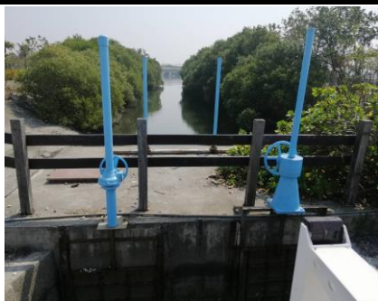
照片〈35〉濕地的水經過各池的過濾，最後流到抽水站。
