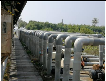
照片〈34〉由抽水站加壓後匯入共用取水池。
