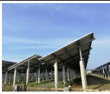
圖〈10〉測量太陽能光電板的方位角，大都為座北朝南
