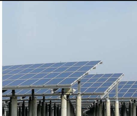
圖〈9〉安裝的太陽能光電板數量以固定式居多
