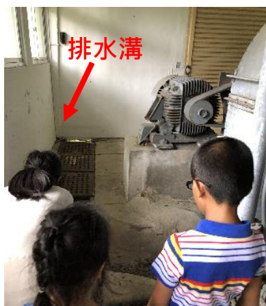
▲ 圖 20 廢水排水道
