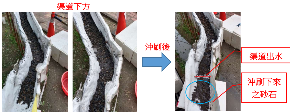
圖 3-3-6、渠道下方砂石沖刷
