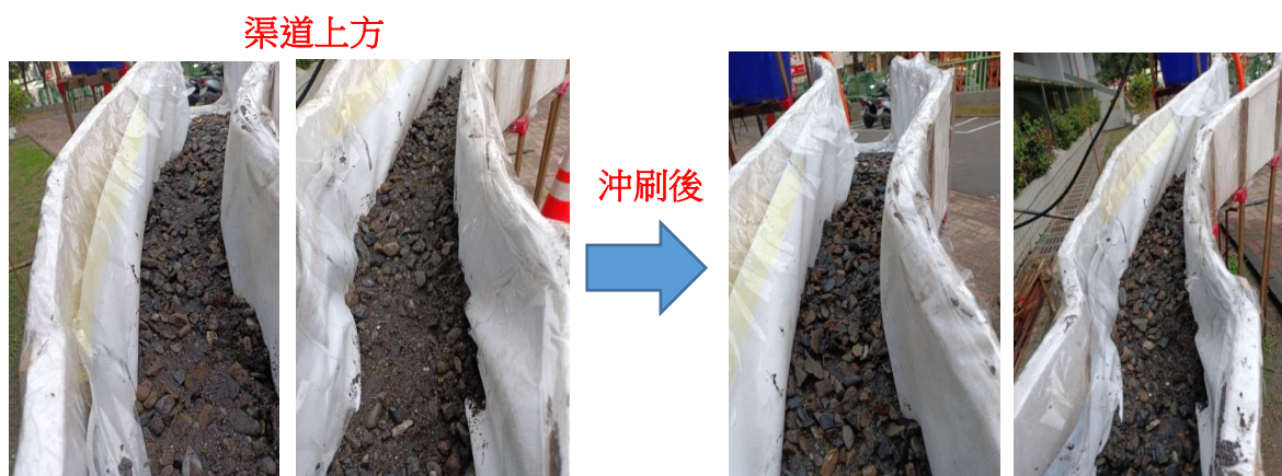
圖 3-3-8、渠道下方砂石沖刷
