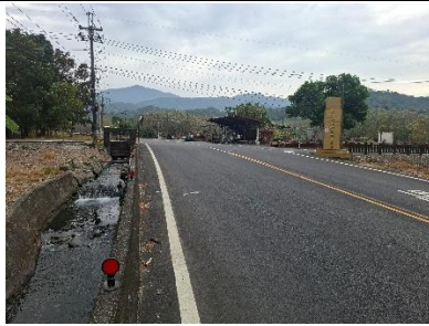
圖 2-35 第 2 個水閘門(反) 溝渠水流的高低落差
