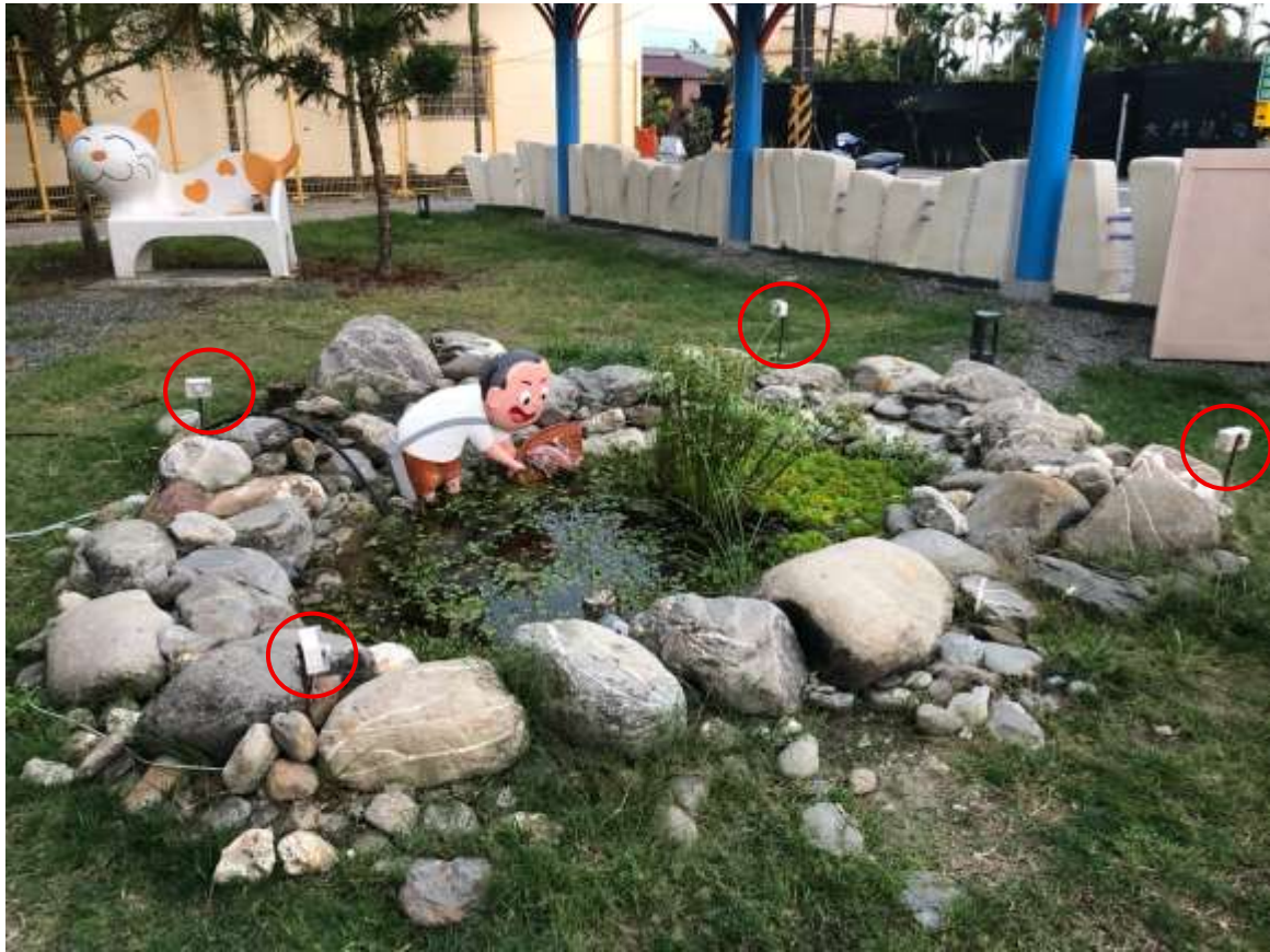
圖一：PIR 人體紅外線感測器設置完成（現場圖）
